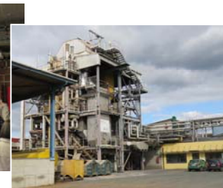
バイオマス発電施設
